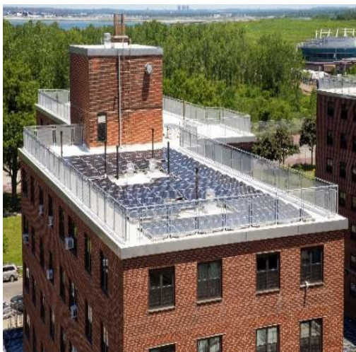
Reparación del techo y del sistema de paneles solares en Ocean Bay (Bayside)
